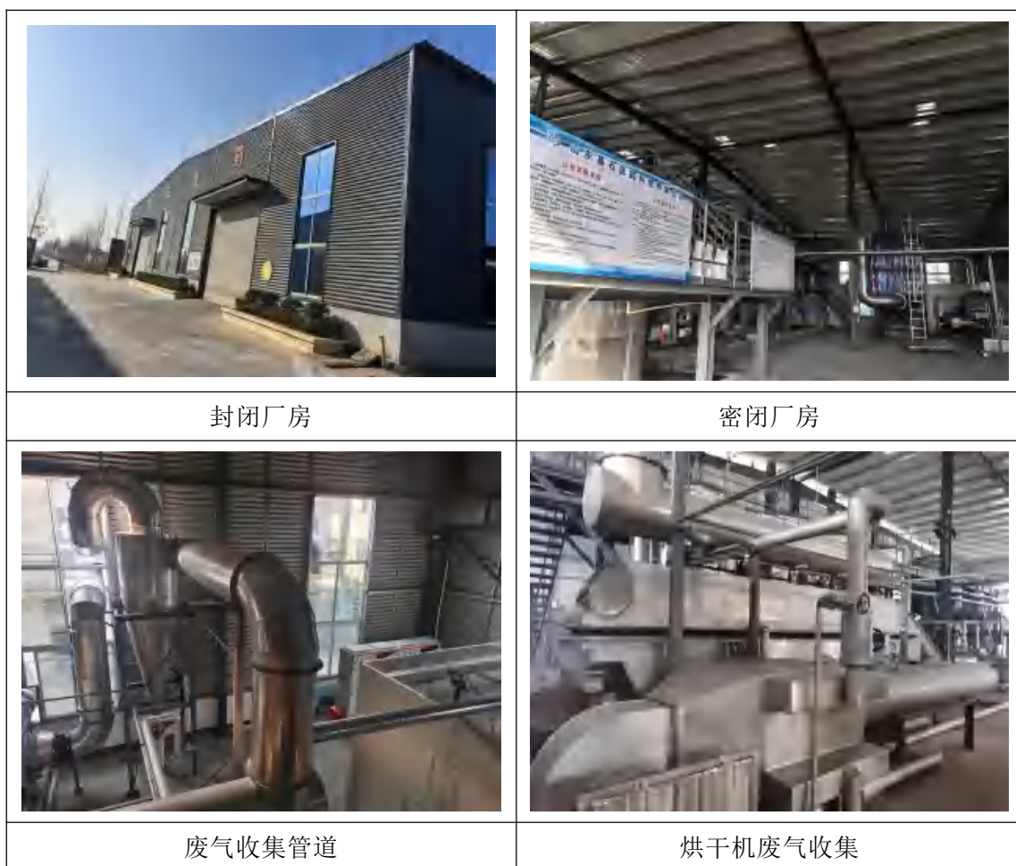
图 4-2 废气处理设施实际建设情况
